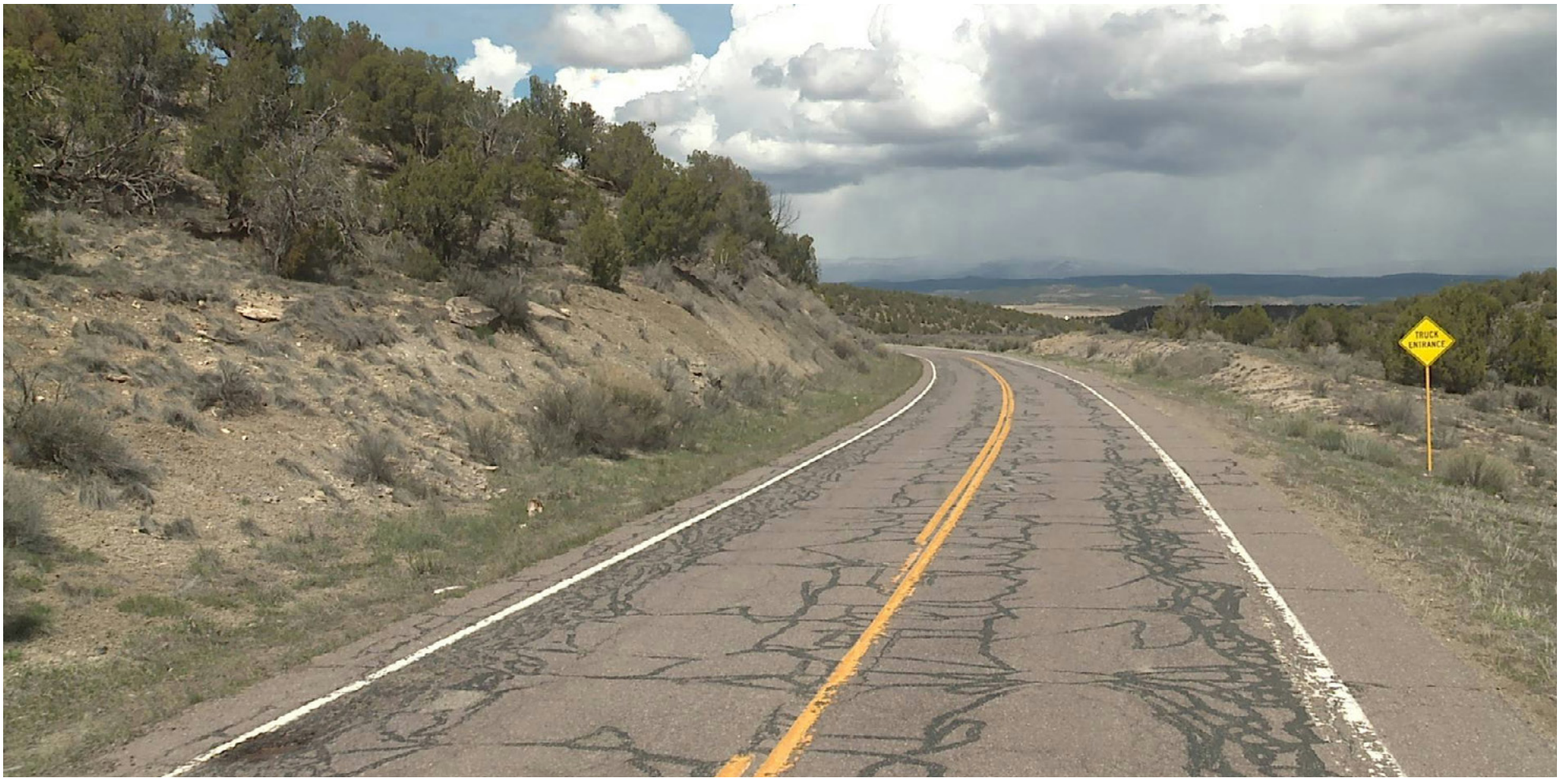
Pavimento en malas condiciones a lo largo de una autopista estatal rural
