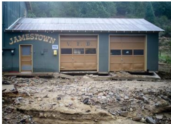
Figura 8: Voluntarios de bomberos en Jamestown dañado por las inundaciones.
